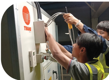
ติดตั้งและดูแลระบบปรับอากาศ
